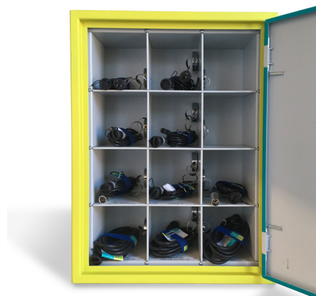
Oplaadkabelkast (LS10) met kabeltreksysteem
